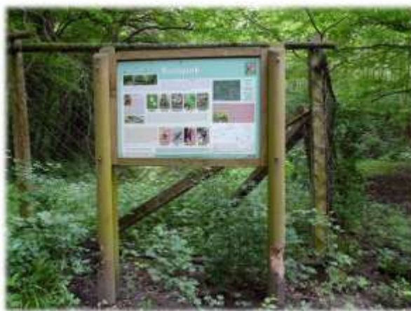
Bobr se někdy z jakéhosi rozmaru pustí do mrtvého dřeva. Jak je patrné z fotografie, nevádí mu ani impregnace. V tomto případě nebral ohledy ani na majetek ochrany přírody a poškodil konstrukci informačního panelu národní přírodní rezervace Ranšpurk.
